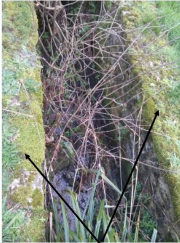
Ruisseau aux berges maçonnées à remplacer par des berges plus naturelles enherbées.
